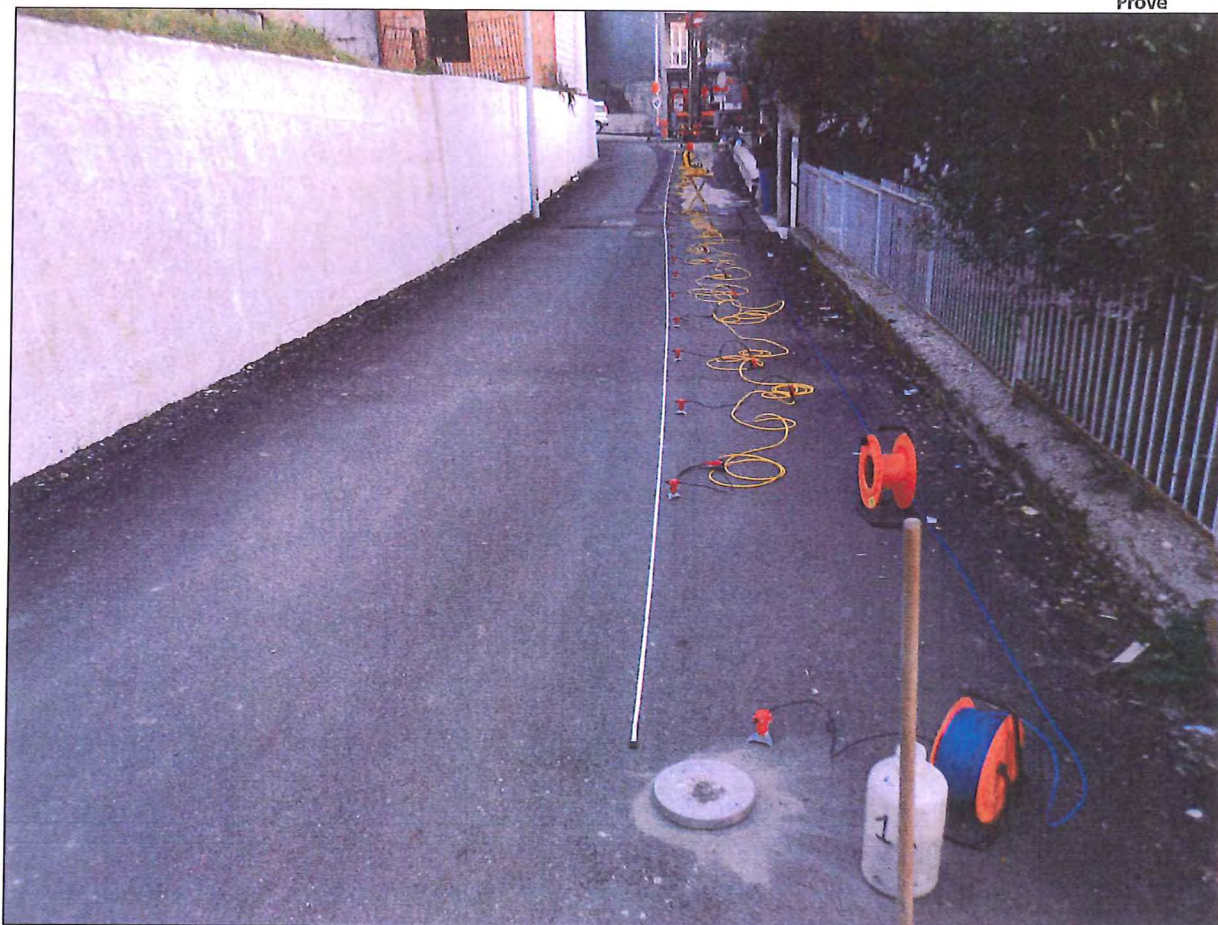
Foto 3. Punto di energizzazione
